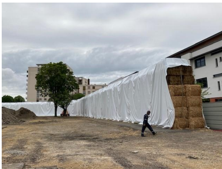
Visuel du mur acoustique périphérique (mur de paille recouvert d’une bâche ignifugée)
